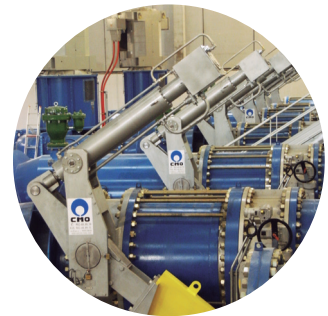
ESTACIONES DE BOMBEO
